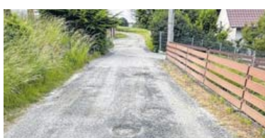
Der Steinweg in Adorfs Pfaffenlohssiedlung ist in schlechtem Zustand. Es bilden sich immer wieder Schlaglöcher.
